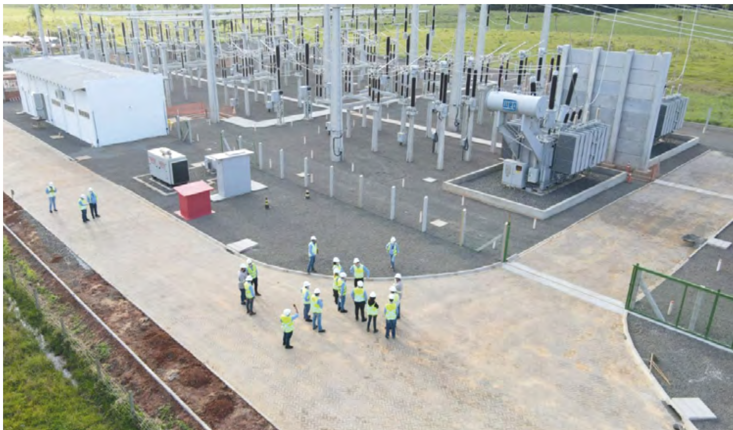
Subestação Torres - 2 no município de Torres, RS. A contratante é WEG Equipamentos Elétricos e a proprietária da obra é EDP do Brasil
