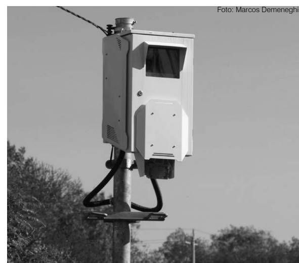
OCR - Leitor e placas e de velocidade instalado na ERS 344
