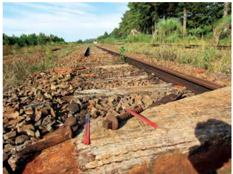
Próximo da Estação são duas pistas que estão com a retirada de material
