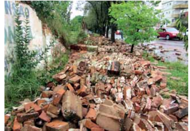
Muro do Antigo Poliesportivo da SER Santo Ângelo cai na Av. Brasil
