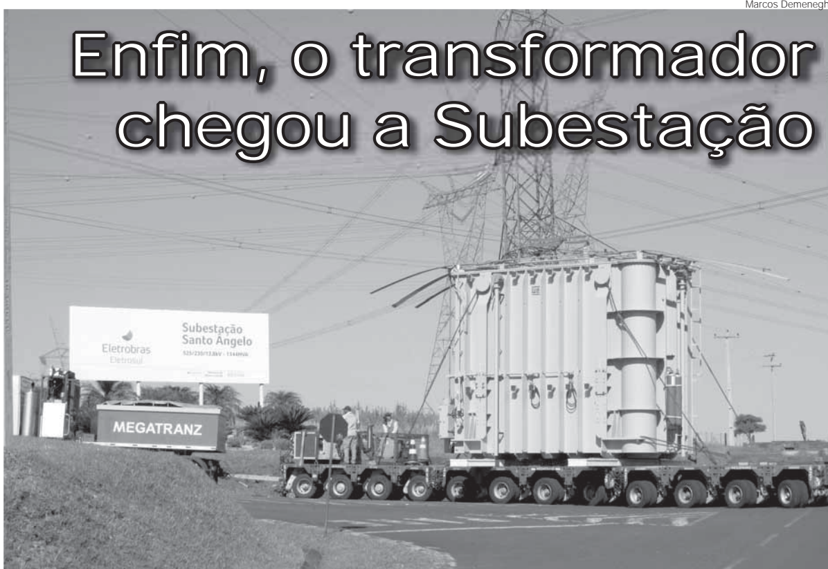
O transformador chegou na Subestação da Eletrobras em Santo Ângelo depois de ser consertado na WEG em Blumenau
