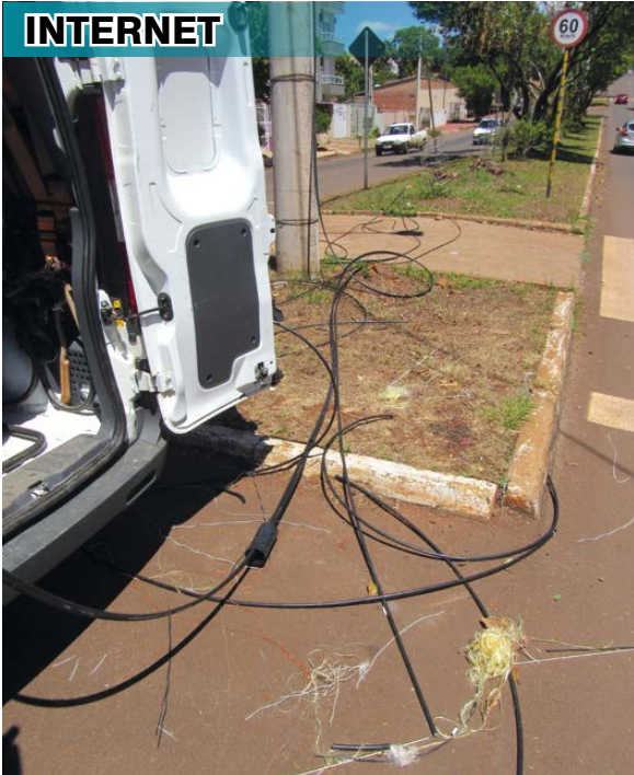
Técnicos reparam o estrago feito pelo corte do cabo
